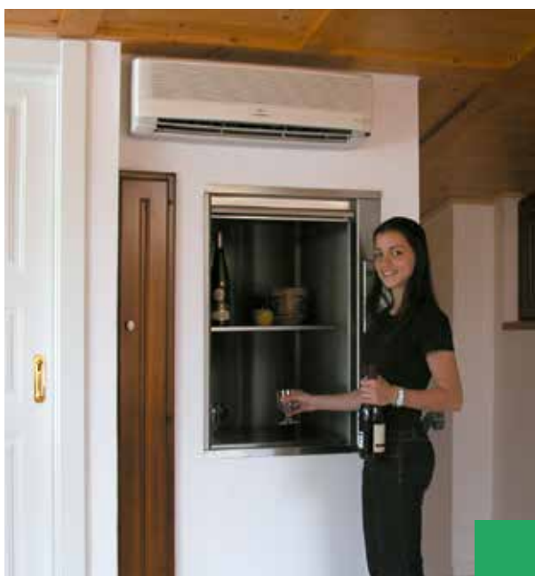
Installazione in una casa privata (Italia), modello 24 kg con finiture in acciaio inox. Grazie al Microlift il trasporto della spesa dal garage alla cucina non è più un problema.
